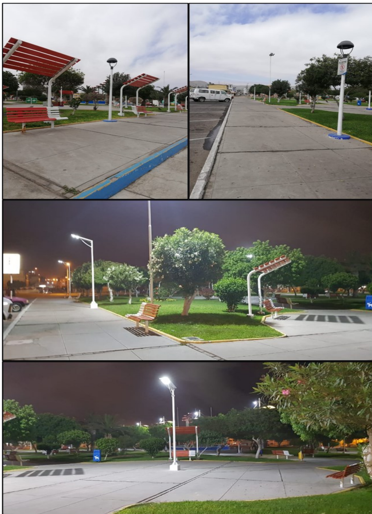
Figura 9. Reemplazo de luminarias ornamentales por luminarias solares fotovoltaicas integradas. Fuente: Elaborado por los autores según especificaciones técnicas.
